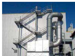
Filtration de la poussière du hangar à cuves
